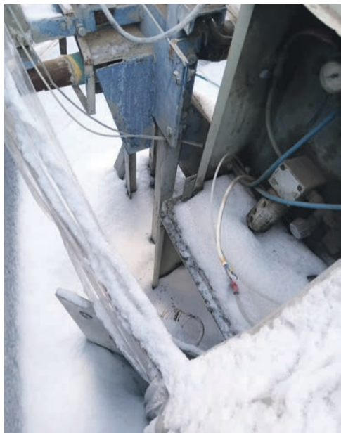
После демонтажа оборудование пришло в негодность
